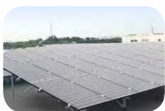
屋顶太阳能系统
